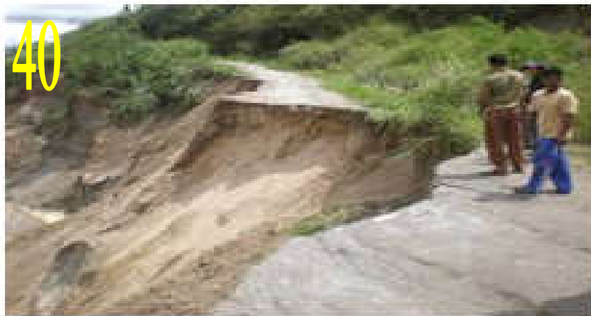
Badan Jalan Longsor Menuju Kampung Rusip
